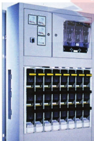
شکل ۳-۱۴ - تابلوی توزیع با کلید فیوز عمودی
